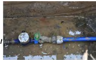
Anschluss für das Bauwasser
